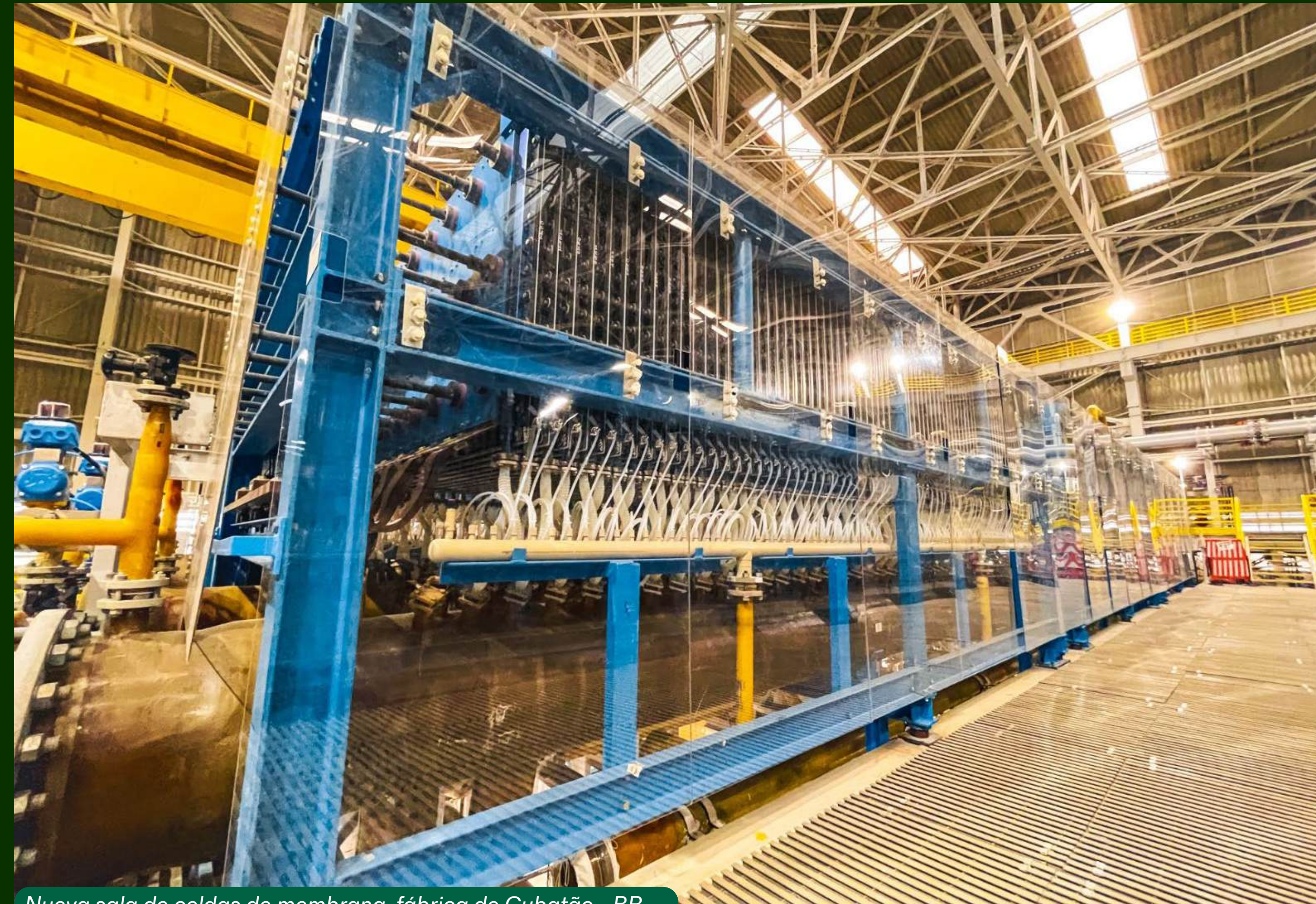
Nueva sala de celdas de membrana, fábrica de Cubatão - BR
