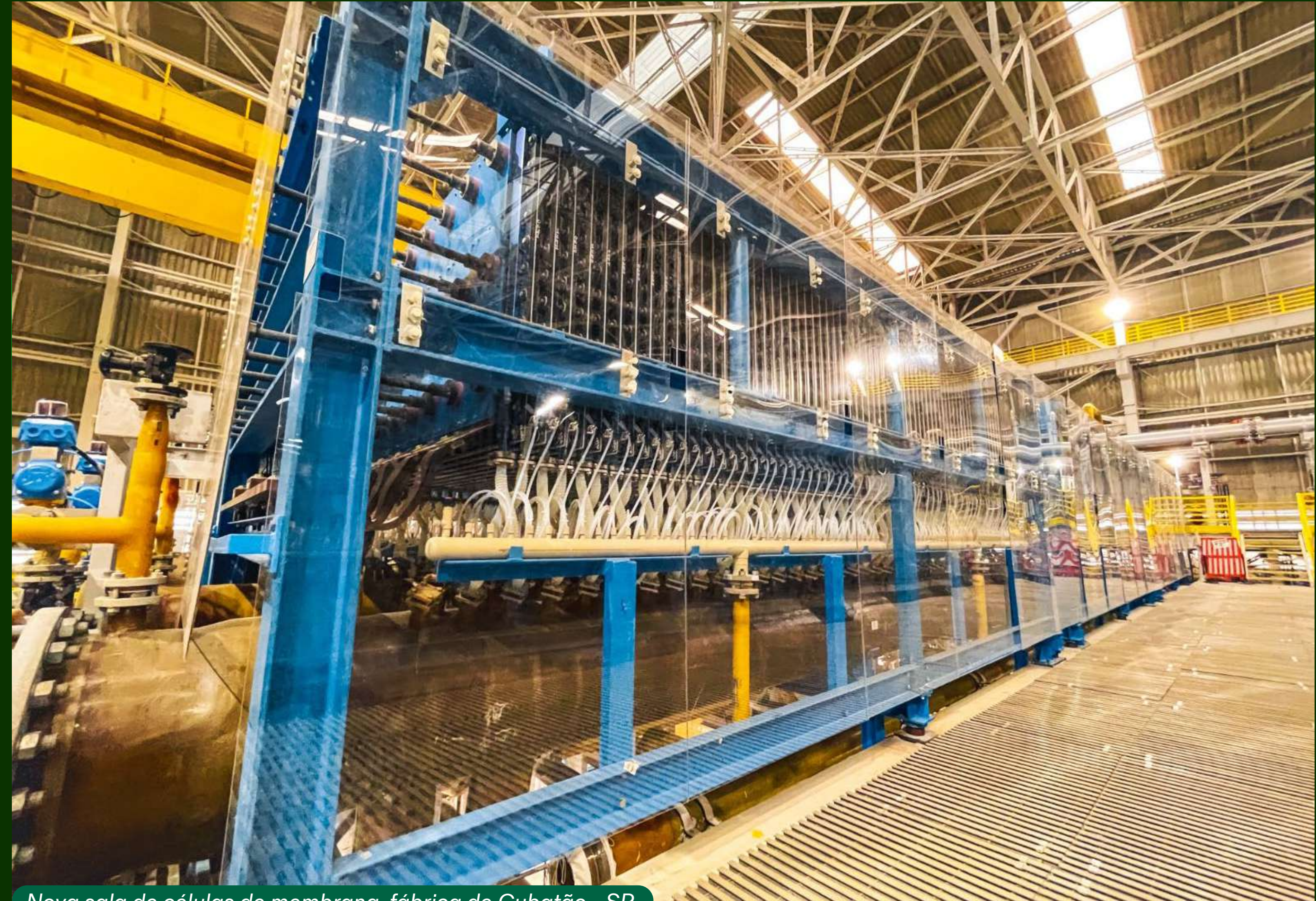
Nova sala de células de membrana, fábrica de Cubatão - SP
